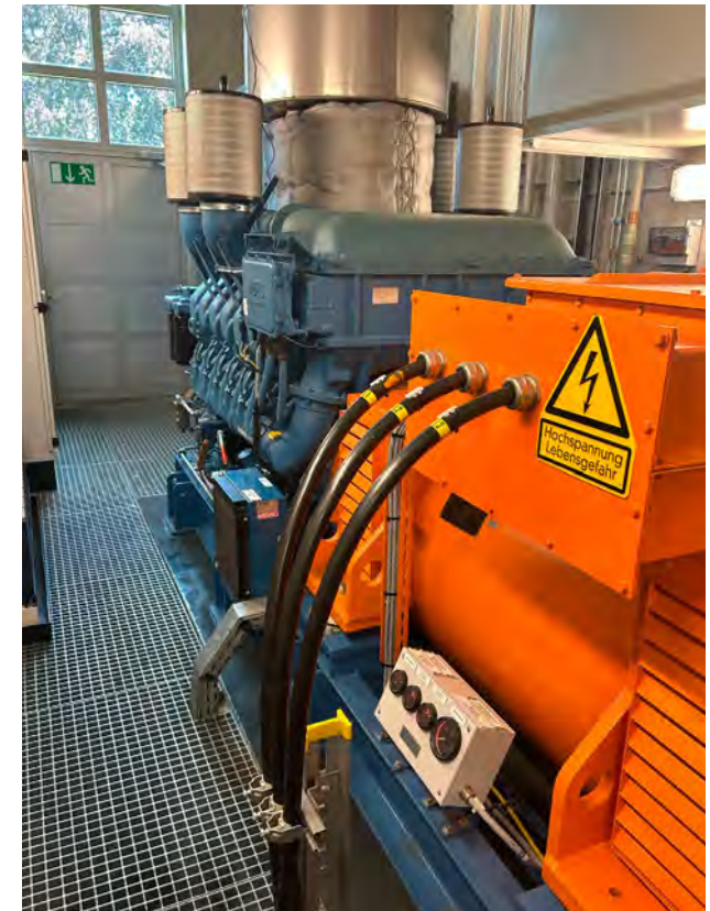
Bild 22.2: Notstromgenerator im Wasserwerk Echthausen Fig. 22.2: Emergency power generator at the Echthausen waterworks
