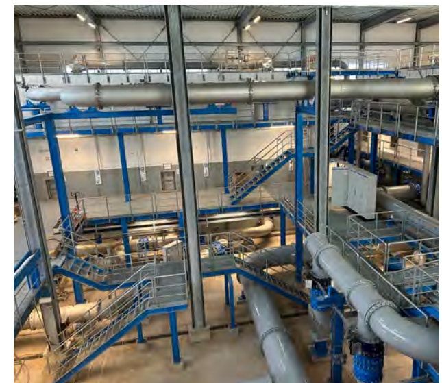
Bild 19.10: Rohrleitungen und Stahlbau in der WAA Fig. 19.10: Pipework and steelwork in the water treatment facility
