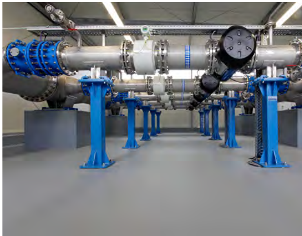
Bild 19.2: UV-Anlage im WW Echthausen
