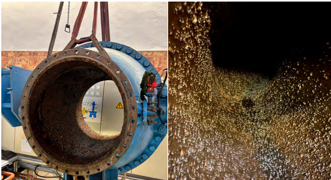
Bild 8.2: Während Instandsetzungsarbeiten am Kraftwerk der Sorpetalsperre wurden im Kugelschieber (links) und in der Kraftwerksleitung (rechts) Quaggamuscheln gefunden. Fig. 8.2: During repair works at the Sorpe Reservoir power plant, quagga mussels were found in the ball valve (left) and in the power plant pipeline (right).
